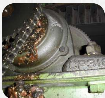
油漏れ・油不足
