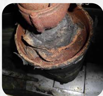
発錆(サビ)・腐食
